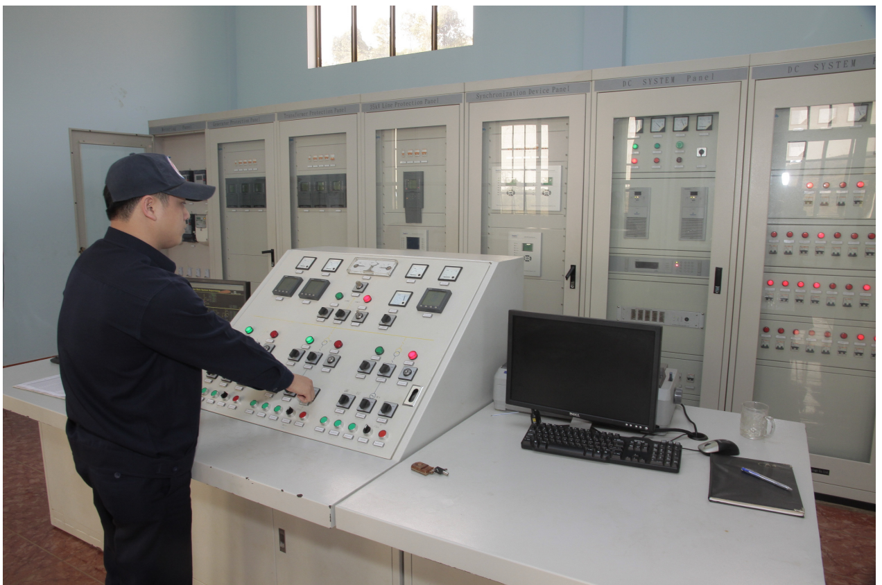
Ảnh: Phòng vận hành Nhà máy IaPuch3 - 6,6 MW, TIC liên doanh đầu tư, đưa vào hoạt động từ năm 2008
