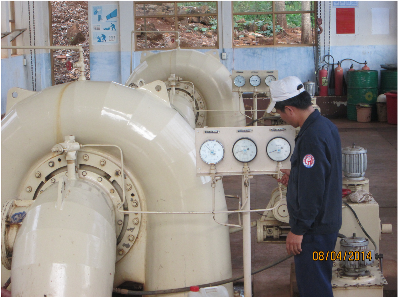
Ảnh: Kiểm tra các thông số máy phát tại nhà máy thủy điện Ia Đrăng I
